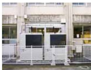
写真 2 室外機設置状況 (GHP)
