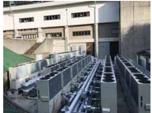
写真① 体育館裏GHPチラー30台設置
