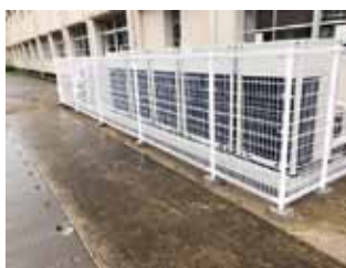
写真 1 室外機設置状況 (EHP)
